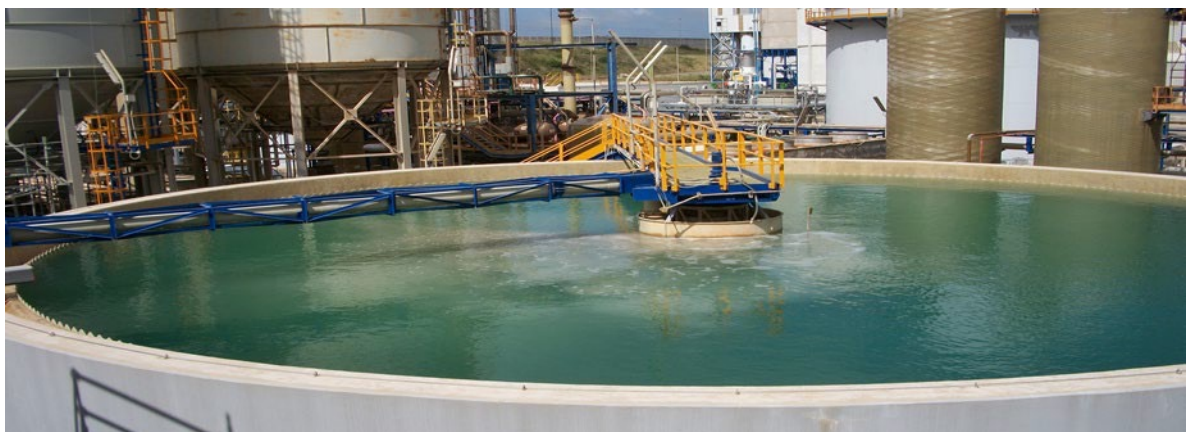
Particolare del depuratore acque
